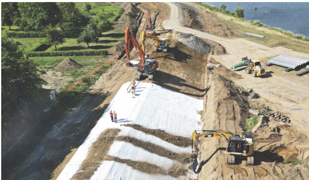
Figuur 1 – Uitvoering bentonietmatten dijkversterking Beesel op het buitentalud en kruin van de dijk en afwerking met een leeflaag van grond.
