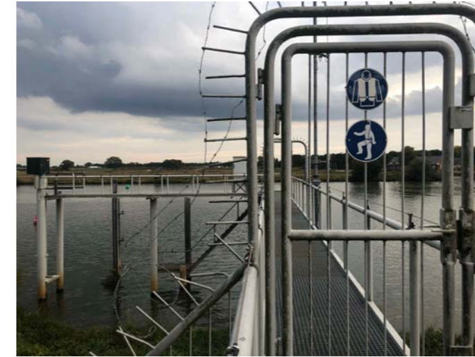
^ Figuur 25 Bestaande situatie meetstation
