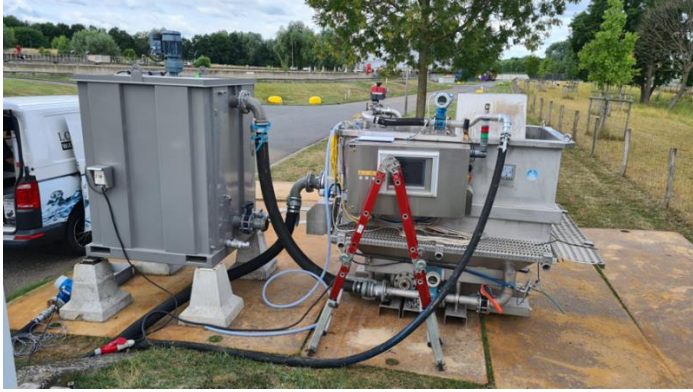
Figuur 47: Opstelling doekfilter installatie op RWZI Hoensbroek
